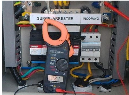
Gambar 4.9 Pengukuran tegangan listrik fase R-N
